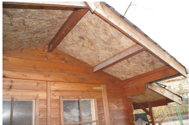
Foto 17: Geräteschuppen – Dachunterseite (Blick nach Nordwesten)
